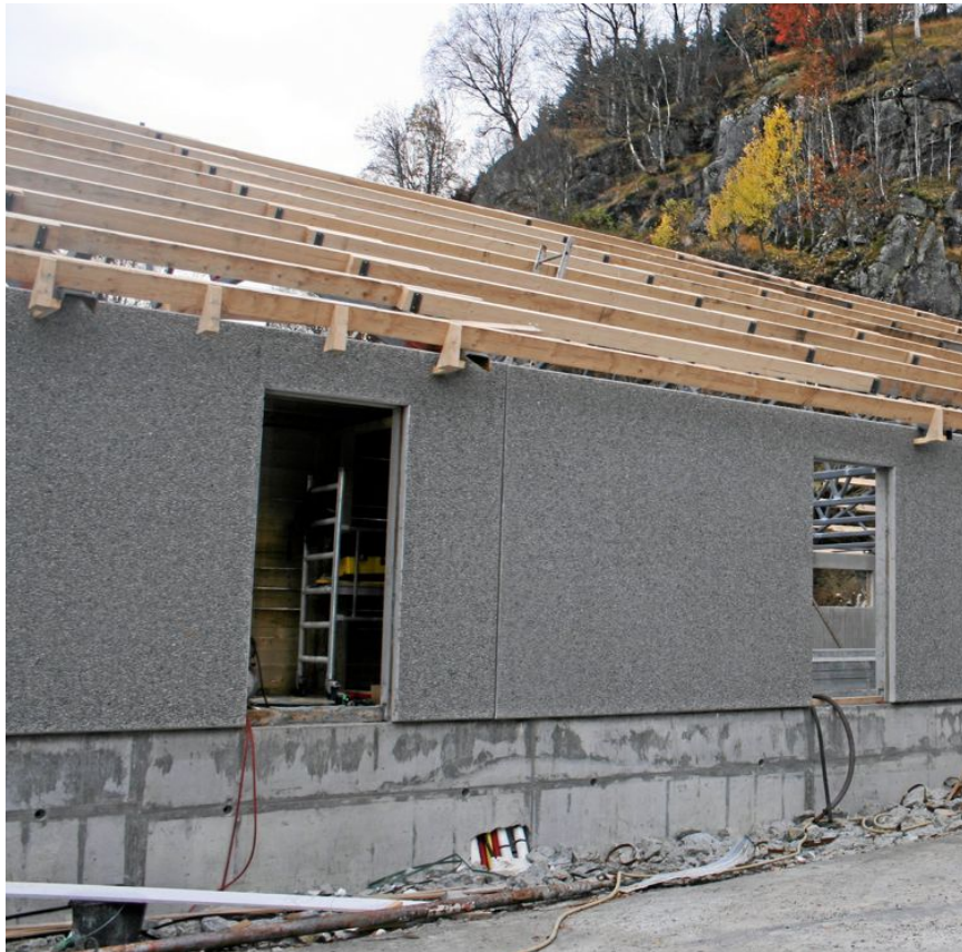
Nytt sauefjes under bygging. Nye regler for økt dyrevelferd kan gi bønder enorme utgifter i årene som kommer.
